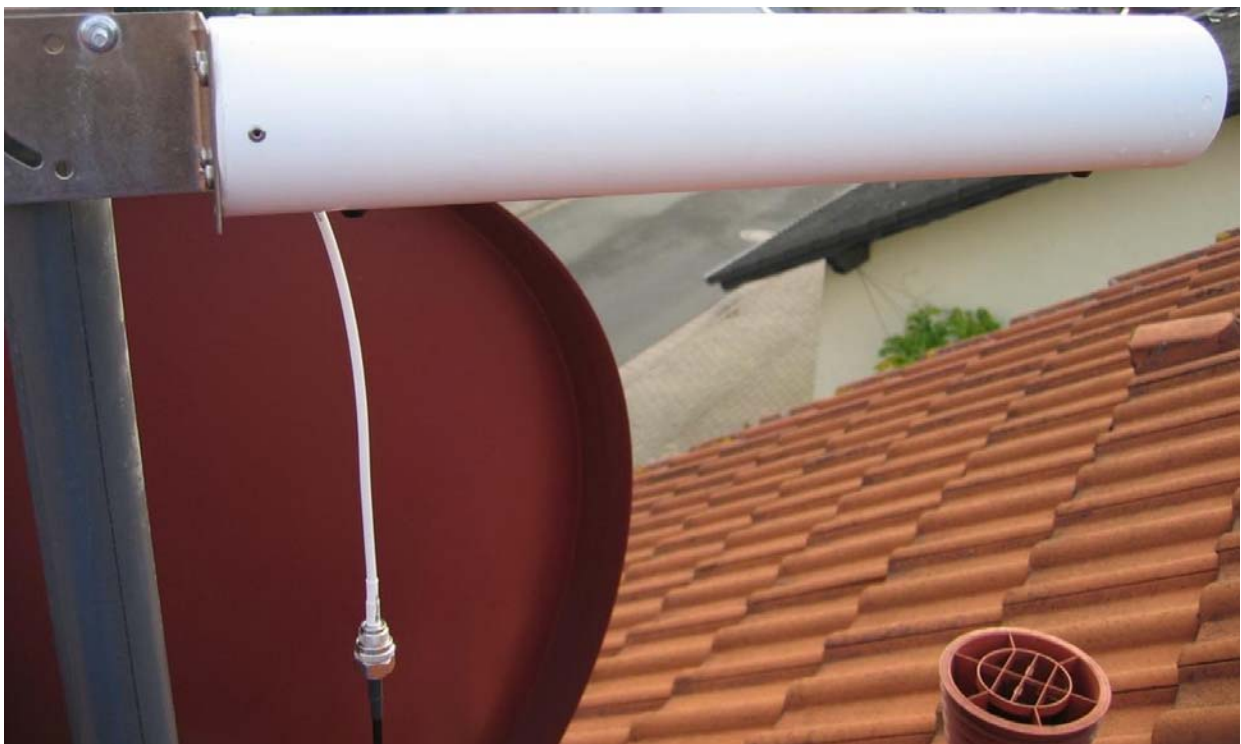
Richtfunkantenne Gebäude B (Yagi Bauform)
