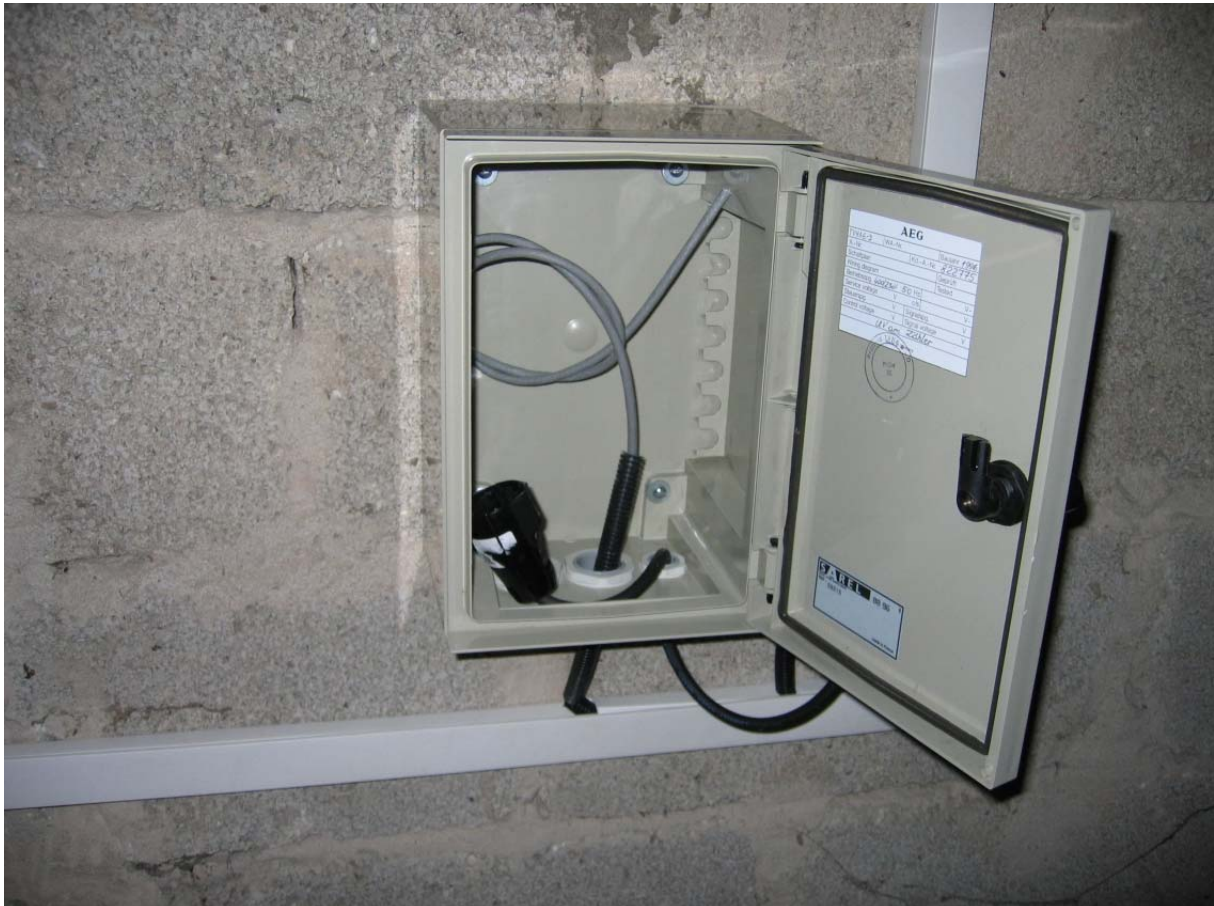
Sicherungskasten, Strom und A-DSL Kabel im Gebäude A
